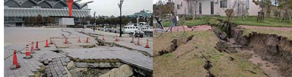
(左) 博多港中央ふ頭におけるイベントヤードのブロック舗装の亀裂・陥没状況 (九州地方整備局より提供) (右) 国営海の中道海浜公園・光と風の広場 (カモ川北側歩道陽動路) (九州地方整備局より提供)
