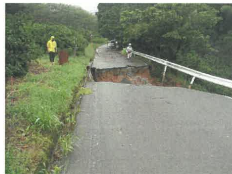
林道の損壊 (みやま市)
