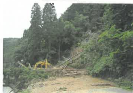
林地の損壊(八女市上陽町)
