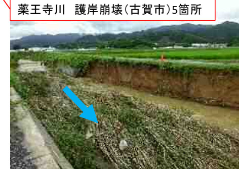
薬王寺川 護岸崩壊（古賀市）5箇所
