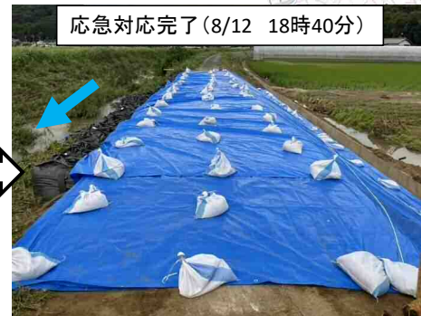
桜井川 堤防決壊（糸島市）
