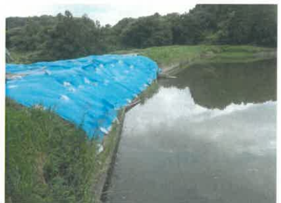
応急対策としてブルーシートを設置したため池併せて、水位低下に向け、排水作業を継続中
