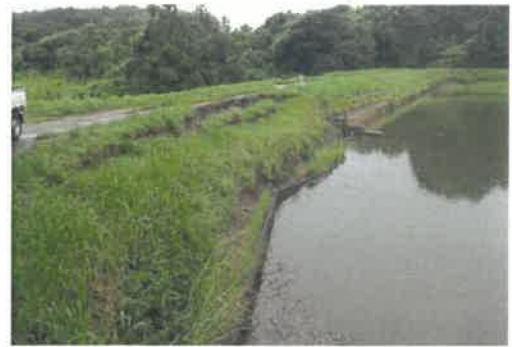
ため池堤体の一部損傷（糸島市二丈）
