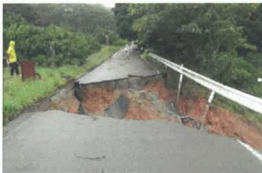
林道の損壊（みやま市女山）
